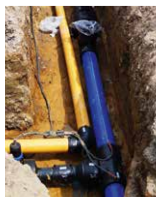
Gas- und Wasserleitungen der BEW unter der Unteren Straße.
